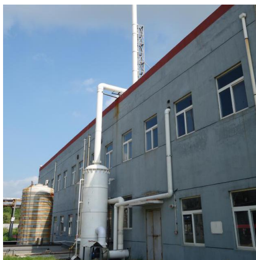
焦亚硫酸钾车间及碱液吸收装置
