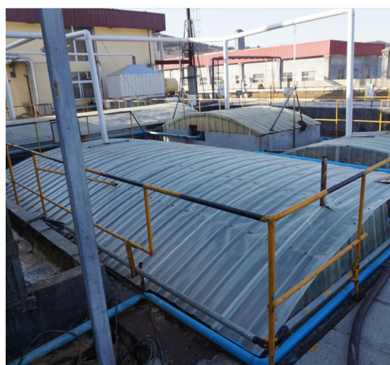
污水处理站（加盖封闭）
